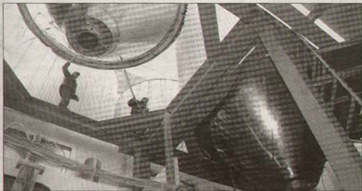
Grössenordnung: Zwei Bauarbeiter dirigieren das untere Ende des Tanks in den 15 Tonnen schweren Metallrohren.
